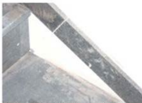
Foto 16. Detalj skiferfliser på trapp og sokkellist Et område manglet skifer og avslørte lim som rent ned i fugen.
